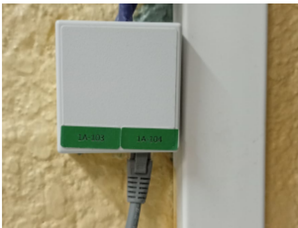
Toma de red doble, proveniente del Rack 1A, con un dispositivo conectado.
