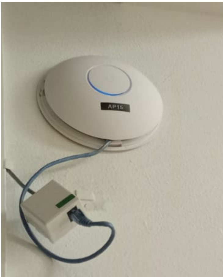
Punto de acceso Ubiquity conectado a Toma de Red.
