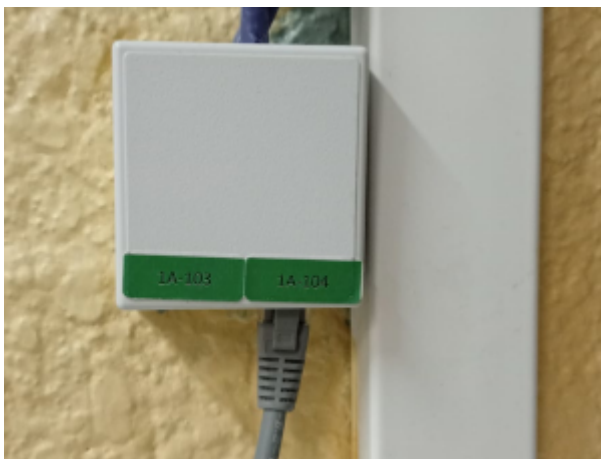
Toma doble con un equipo conectado en uno de los
